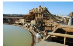
Installation avec son clarificateur
