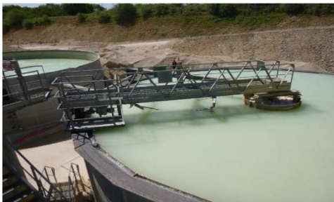
unité de clarification en fonctionnement
