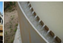
surverse de l'eau claire d'un clarificateur
